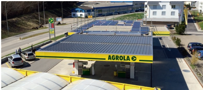
La nouvelle installation photovoltaïque sur le TopShop Bauma.
