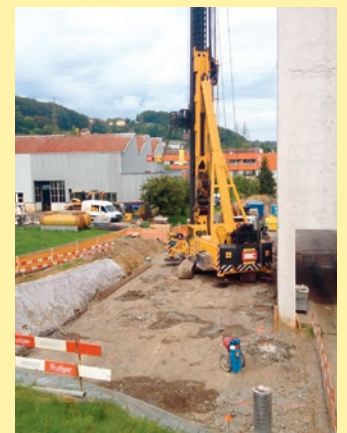
C'est ici que sera érigée la nouvelle tour pour le stockage des produits finis (état: automne 2014).
