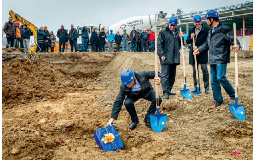
L'ambiance était à la fête lors de la pose de la première pierre à LANDI Baar. Photo: fotozug.ch
